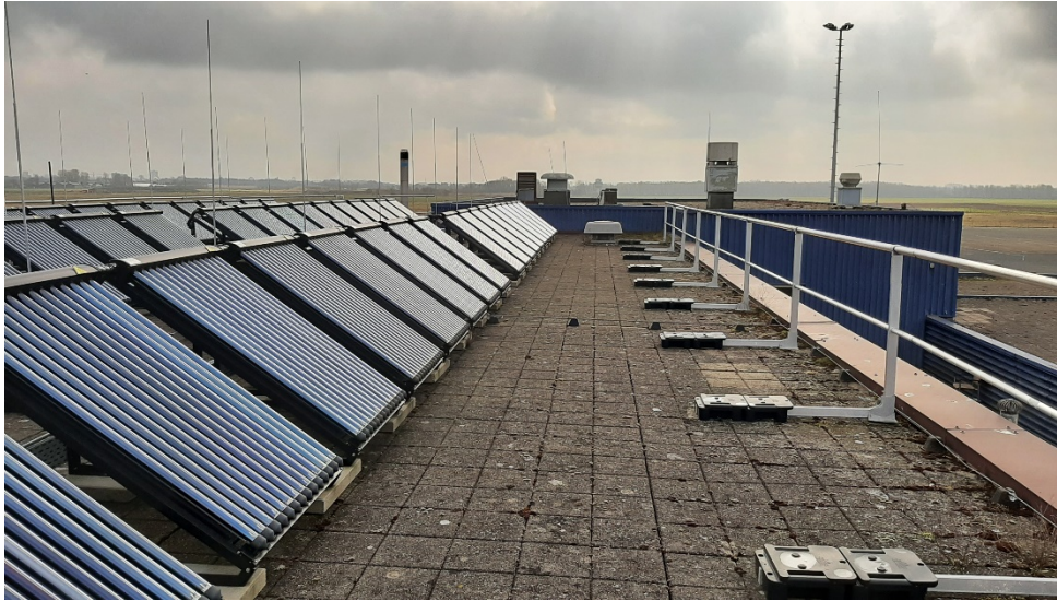
Figuur 4 - Overzicht dak met PVT-panelen
