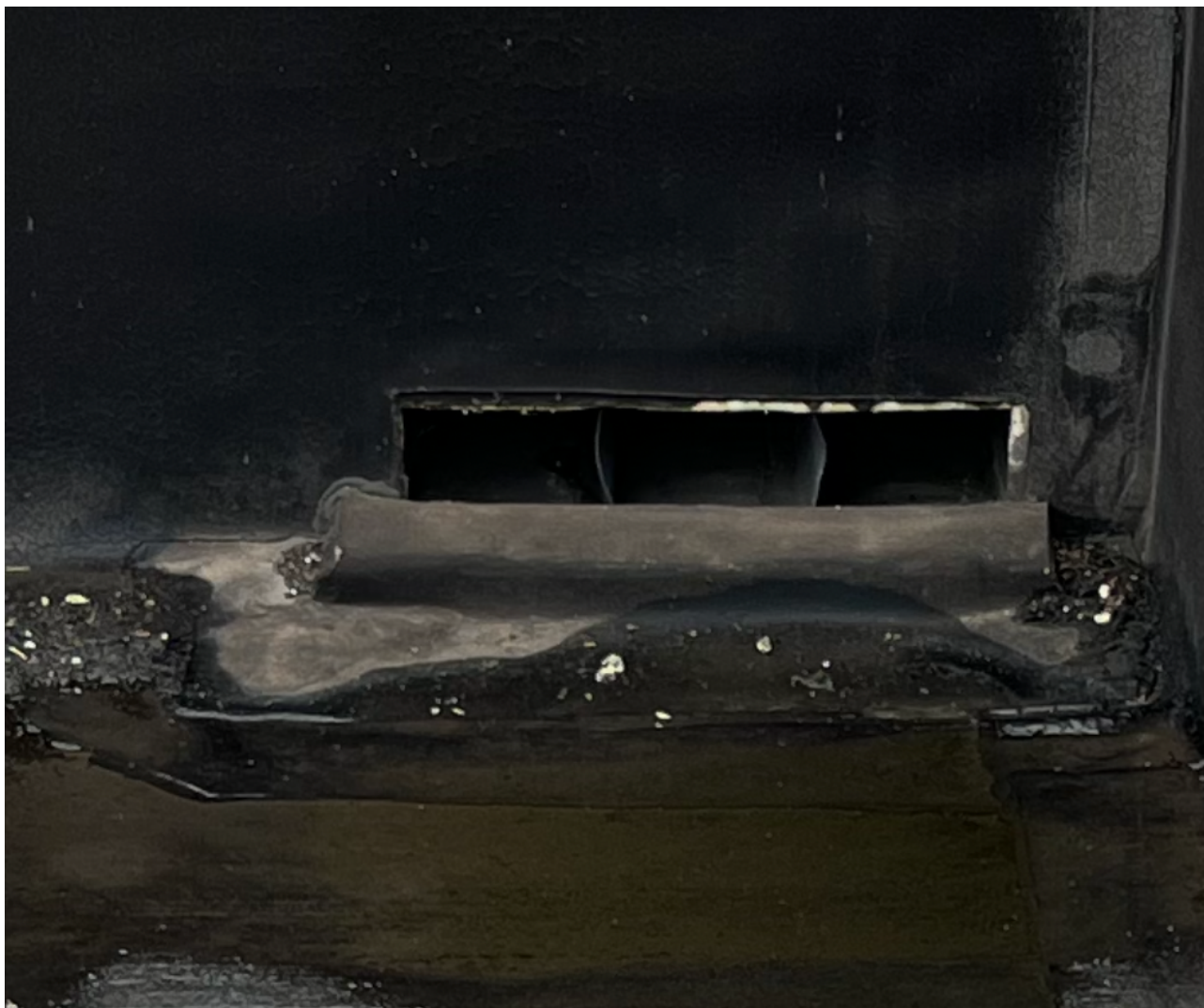
Foto 11: hoge drempel nooduitlaat.
