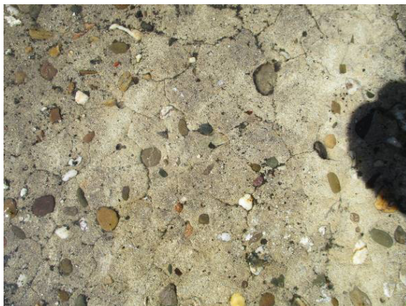
Schade: Craquelé in beton bovenzijde natte kelder. Daarnaast is de toplaag afgesletten. Oorzaak: Krimp tijdens uitharden van het beton. Risico: Geen direct risico. Maatregel: Aanbevolen wordt om een slijtlaag/afwerklaag aan te brengen op de bovenzijde van de natte kelder.
