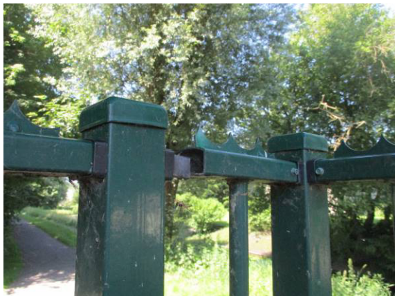
Schade: Het hekwerk is op twee locaties beschadigd. Oorzaak: Mogelijk ten gevolge van verzakkingen en/of mechanische invloeden. Risico: Functieverlies van het hekwerk. Maatregel: Herstellen hekwerk.
