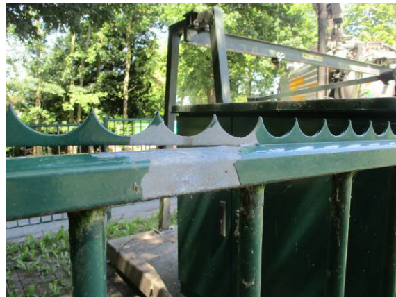
Schade: De conservering op het hekwerk bladdert op meerdere locaties. Oorzaak: Onvoldoende hechting van de verf op het verzinkte staal. Risico: Verminderde esthetica. Maatregel: Vervangen conservering stalen hekwerk.
