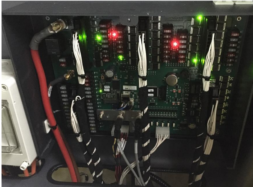
Voorbeeld gebruikte zekeringkast met LED aanduiding.
