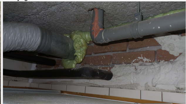
Afvoerleidingen en ventilatiekanalen.
