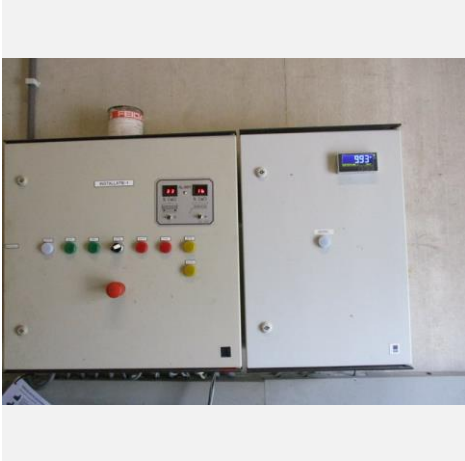
Menginstallatie 1 met niveau buffertnk 1
