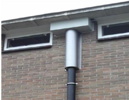
Figuur 5 - Voorbeeld van een stijgleiding tegen de gevel
