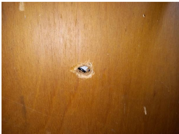
Overzicht destructief onderzoek houten beplating voor spouwmuur geen asbestverdachte materialen achter de houten betimmering
