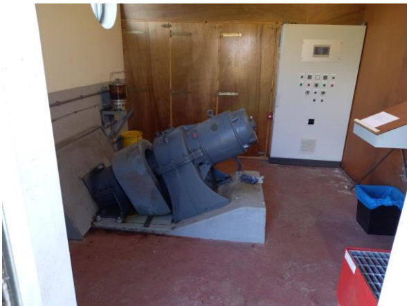
Overzicht binnenzijde gemaal met beton vloer
