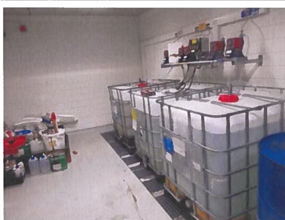
Opslagruimte gevaarlijke vloeistoffen
