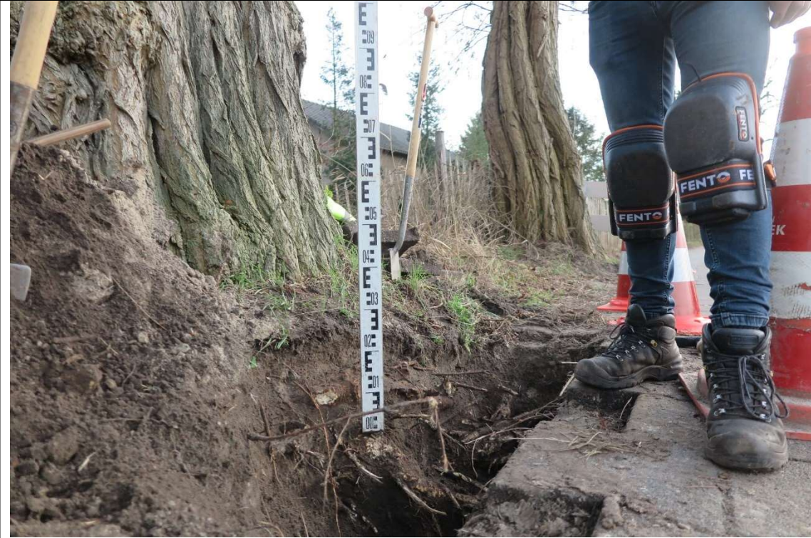
Zware beworteling op 0,1 m onder maaiveld op ca. 1,35 m uit opsluitband asfalt
