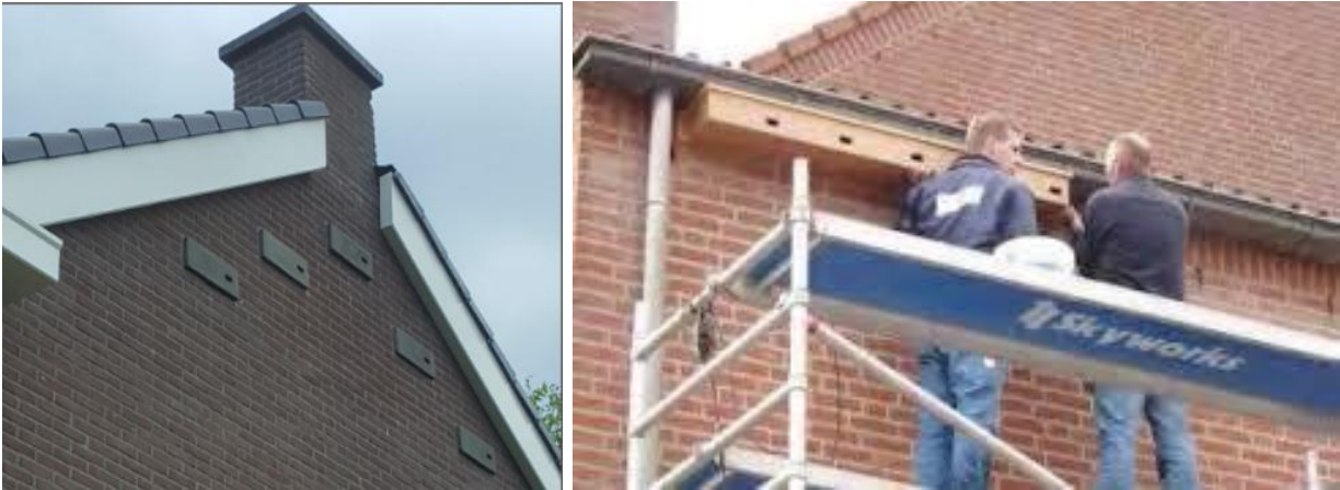
Figuur 15: Speciale inbouwneeststenen als broedlocatie voor de Gierzwaluw en nestkasten onder de dakrand.
