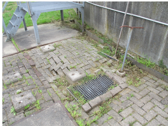
Schade: Rondom de in-/uitstroom opening is het straatwerk verzakt. Oorzaak: Waarschijnlijk uitspoeling. Risico: Struikelen van personen. Maatregel: Herstellen bestrating (lokaal).
