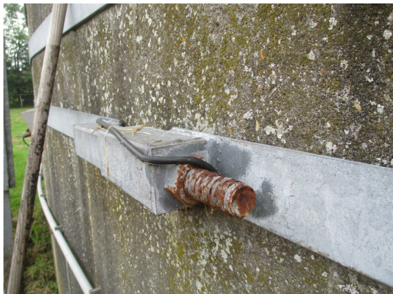
Schade: Beginnende corrosie boutmoer verbindingen klembanden. De klemband zelf is niet gecorrodeerd. Oorzaak: Einde levensduur zinklaag (bouten/moeren). Risico: Verminderde restlevensduur klembanden. Maatregel: Geen directe maatregel benodigd.
