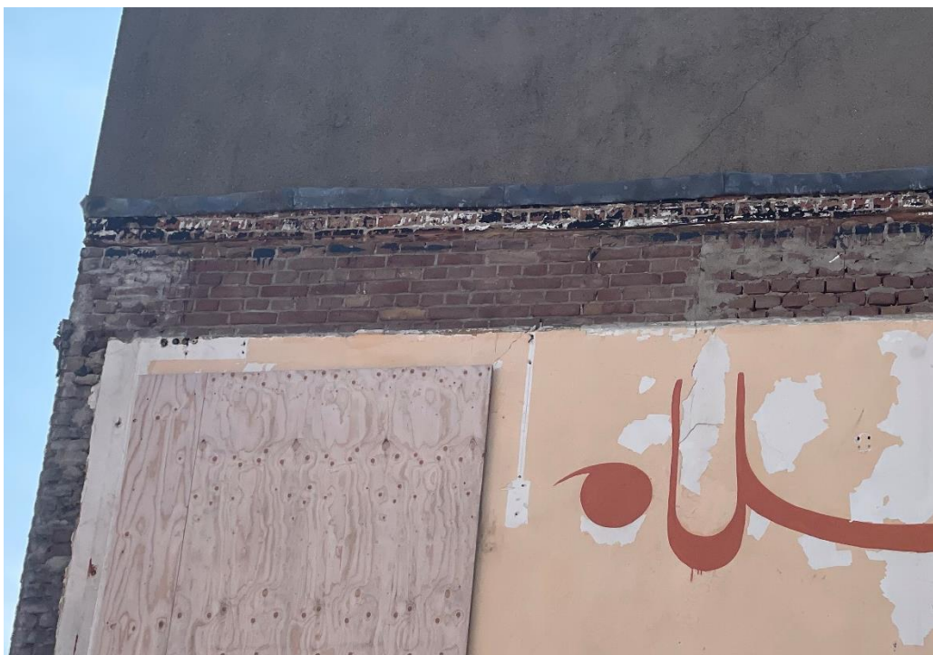
Lichte diagonale scheur boven gevelopening
