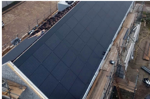
Energieopwekking: zonnepanelen als dak
