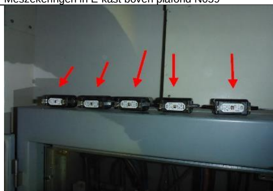
Zekeringen op E-kast ruimte N058
