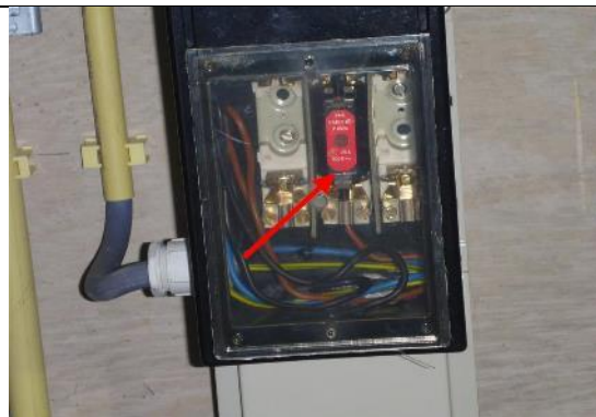
Meszekeringen in E-kast boven plafond N059
