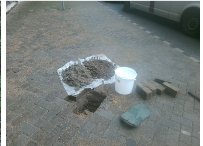
Foto 3: Asbestgat met aangetroffen puinfundering bij boornummer 10.
