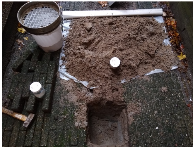
Foto 5: Asbestgat en boring (tot 0,5 m-mv) combi bij boornummer 14.
