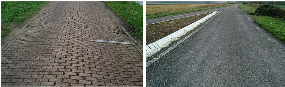
Figuur 1 Schades dwarsonvlakheid en rafeling
