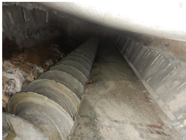
Foto 10: Lichte corrosie en mechanische schade vijzel
