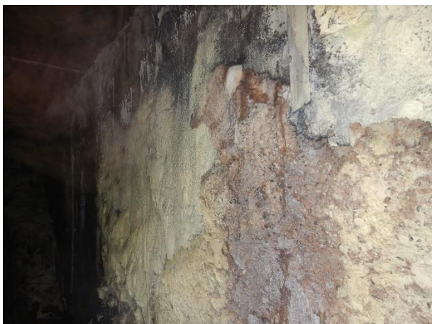
Foto 7: vervuiling wanden vijzelcompartiment
