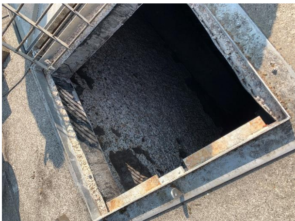
Foto 1: Aantasting beton ontvangwerk
