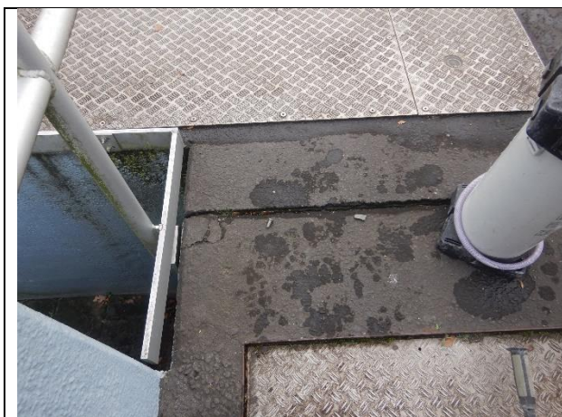
Foto 11: verzakking afvoergoot t.o.v. zandvang
