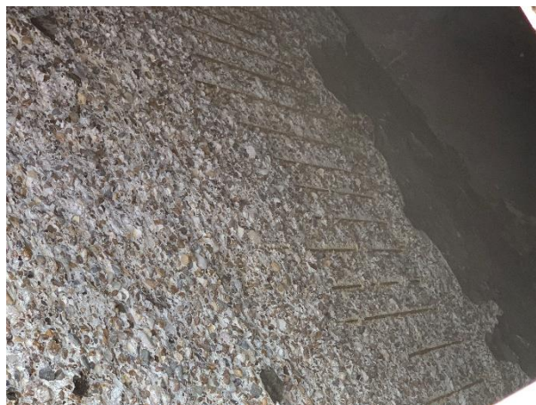
Foto 2: Aantasting beton ontvangwerk met blootliggende wapening
