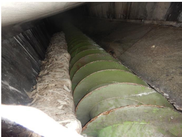
Foto 9: Lichte corrosie en mechanische schade vijzel
