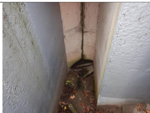
Foto 12: verzakking afvoergoot t.o.v. zandvang
