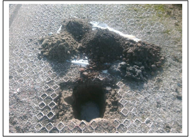
Foto 8. Opgegraven en gezeefd materiaal inspectiegat A09
