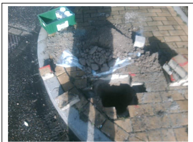
Foto 5. Opgegraven en gezeefd materiaal inspectiegat A06
