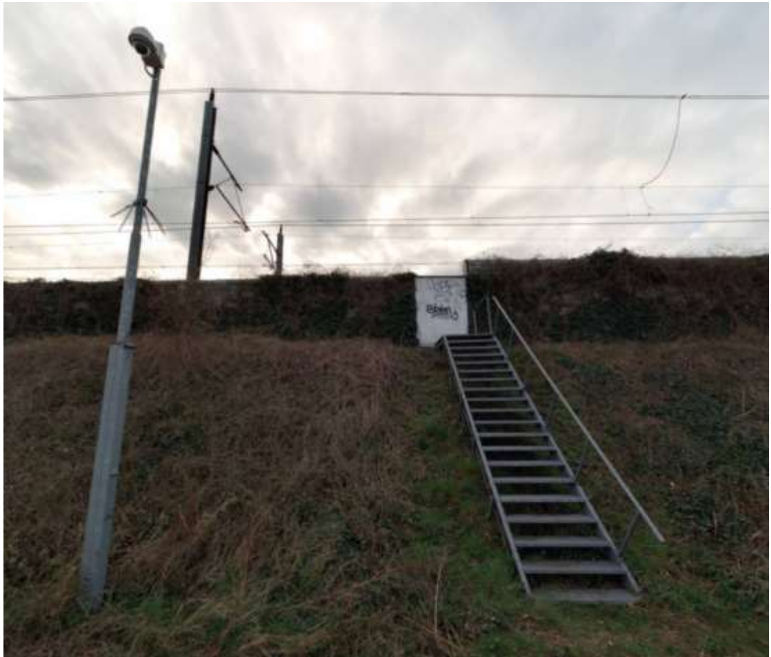
Figuur 3 Laagspanningskabel camera-mast in beheer bij gemeente Stichtse Vecht
