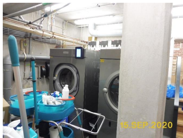
Wasmachines en wasdrogers opgesteld onder het bereik van een rookmelder.
