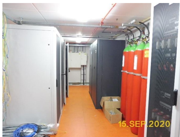
Inkijk in de serverruimte.
