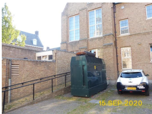
Het noodstroomaggregaat in buitenopstelling.
