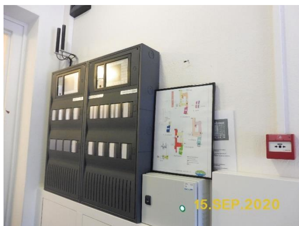
De hoofdbrandmeldcentrale (netwerk).
