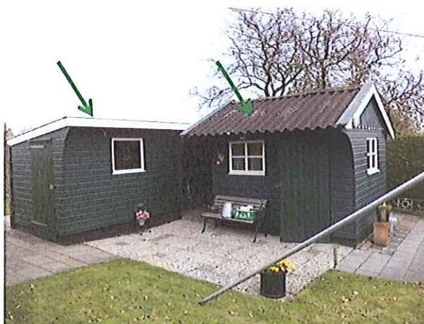
Foto 9. Niet-asbesthoudende golfplaten op bergingen woning (mm4)
