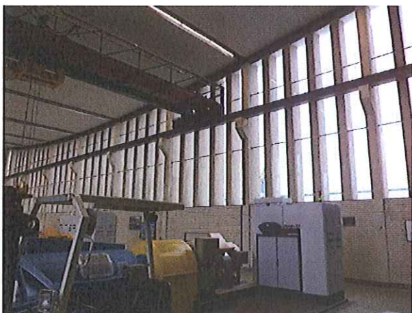
Foto 3. Asbesthoudende kit kozijnen buitengevel gemaal (mm2)
