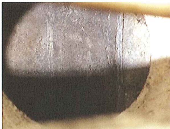
Foto 8. Asbesthoudende ontluchtingsbuis kelder dak in woning (mm5)
