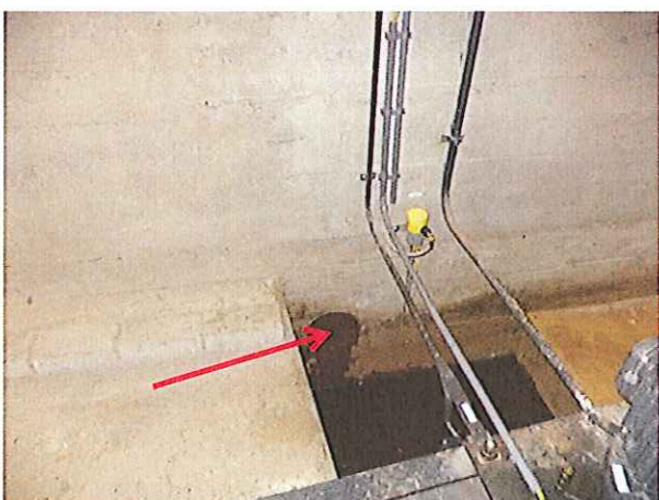
Foto 5. Asbesthoudende buis in kelder -2 gemaal (mm5)
