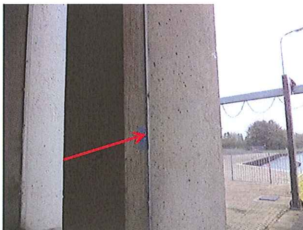
Foto 2. Asbesthoudende kit kozijnen buitengevel gemaal (mm2)
