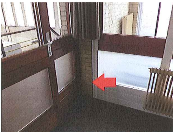
Foto 4. Asbesthoudende kit kozijn kantoor verdieping gemaal (mm3)
