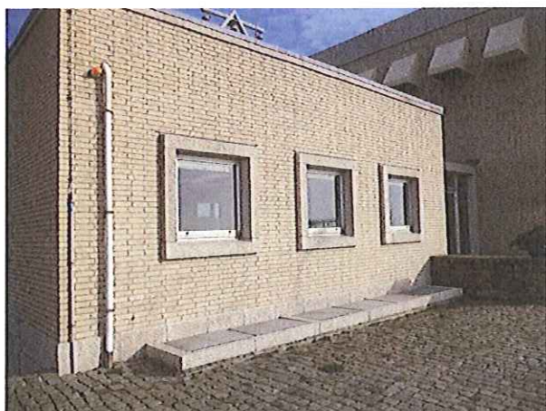
Foto 7. Niet-asbesthoudende kit aluminium kozijnen buitengevel gemaal (mm7)
