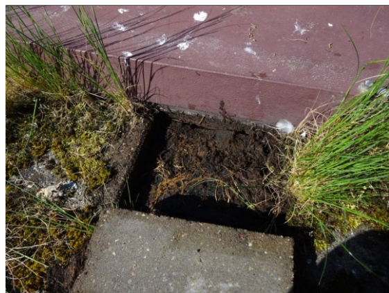
Foto 30 - Nabij opstand hoger opgaand gevelwerk vervuiling en plantengroei in grind-vulstrook
