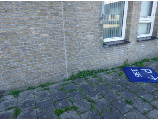
Foto 3 - Scheurvorming (lokaal) in steens metselwerk van achtergevel
