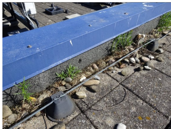
Foto 42 - Langs dakrand in grind-vulstrook aanmerkelijke vervuiling en plantengroei
