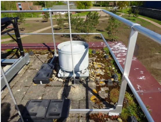
Foto 49 - Langs dakrand in grind-vulstrook aanmerkelijke vervuiling en plantengroei
