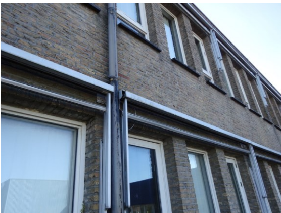
Foto 15 - Verstopte standleiding voorgevel
