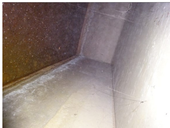
Foto 60 - De kruipruimte heeft geen verbinding met kantoor (geen kruipluik/ruimte)
