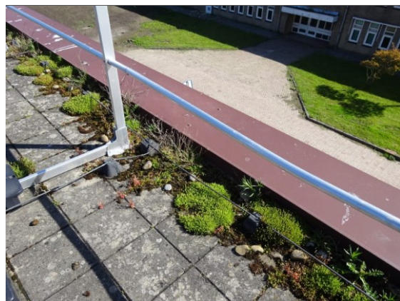
Foto 24 - Langs dakrand in grind-vulstrook aanmerkelijke vervuiling en plantengroei
