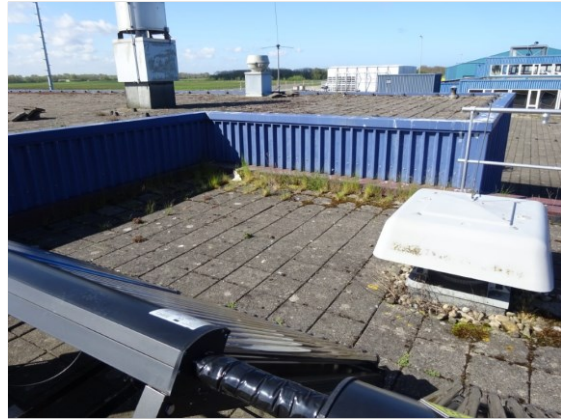
Foto 26 - Nabij opstand hoger opgaand gevelwerk vervuiling en plantengroei in grind-vulstrook
