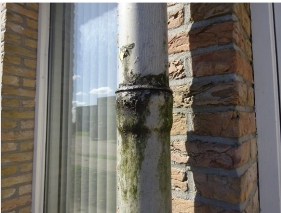
Foto 57 - Verstopte standleiding voorgevel
