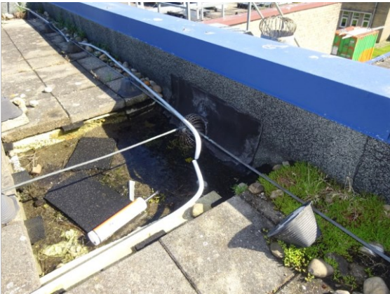
Foto 33 - De isolatie en ballast is na herstel niet gecorrigeerd
