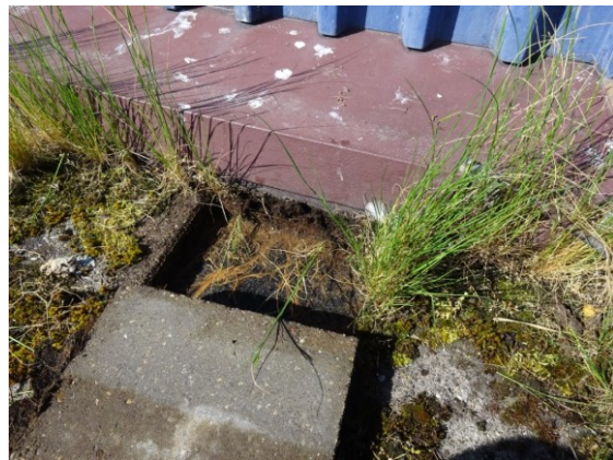
Foto 28 - Nabij opstand hoger opgaand gevelwerk vervuiling en plantengroei in grind-vulstrook
