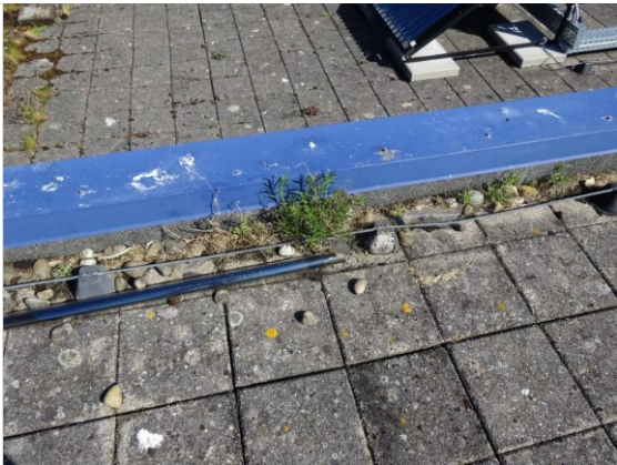
Foto 37 - Nabij opstand hoger opgaand gevelwerk vervuiling en plantengroei in grind-vulstrook.
