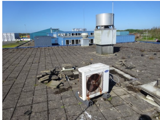
Foto 34 - De isolatie en ballast is na herstel niet gecorrigeerd
