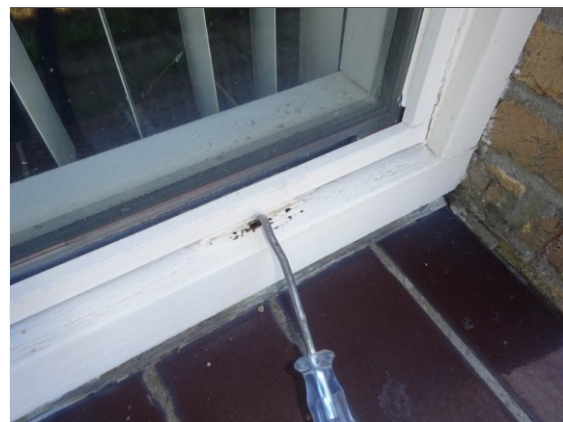
Foto 12 - Vaststelling houtrot kozijnen achtergevel
