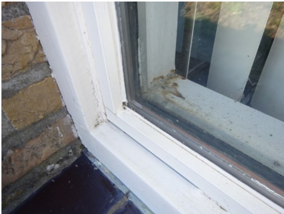
Foto 13 - Waterdoorslag via verstekhoeken geeft houtaantasting binnenzijde
