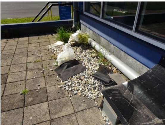
Foto 51 - Langs dakrand opstand in grind-vulstrook aanmerkelijke vervuiling en plantengroei, locatie dakterras
