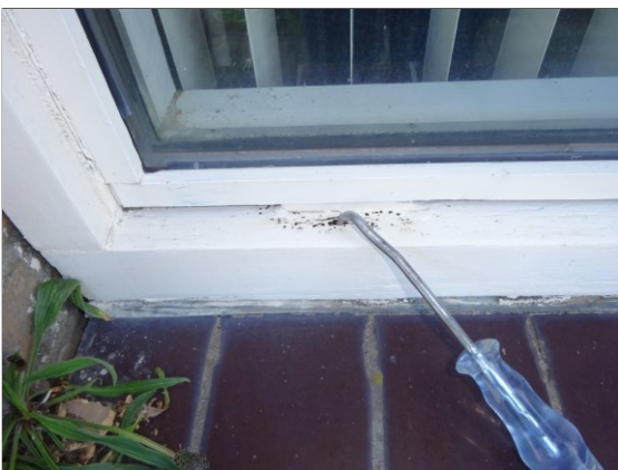
Foto 11 - Vaststelling houtrot kozijnen achtergevel
