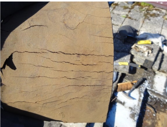
Foto 21 - Bij buiging dakbedekking aanzet scheurvorming (verouderingskenmerk)
