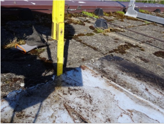
Foto 19 - Dikte isolatie XPS (90 mm) in langsrichting tot aan noklijn aanwezig
