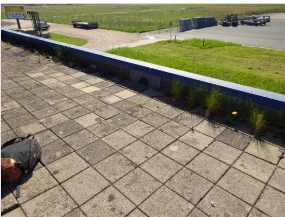
Foto 53 - Langs dakrand opstand in grind-vulstrook aanmerkelijke vervuiling en plantengroei, locatie dakterras
