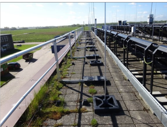
Foto 23 - Langs dakrand in grind-vulstrook aanmerkelijke vervuiling en plantengroei
