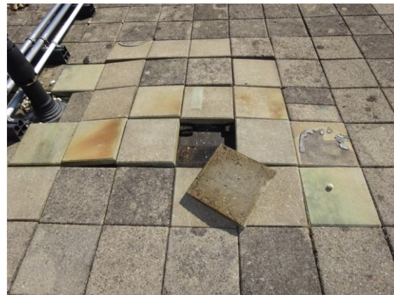
Foto 52 - Verdikkingen onder de dakbedekking (gesloten sparingen, ingesloten opstanden e.d.)
