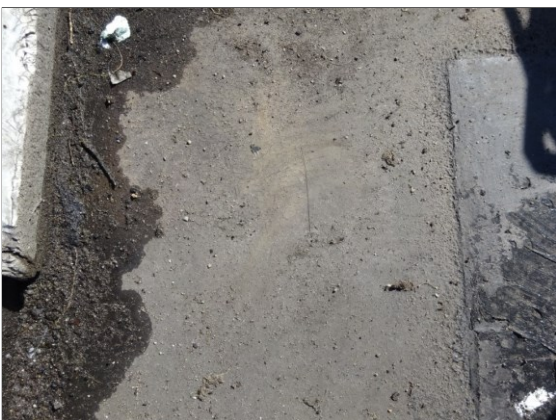
Foto 35 - In de door zon belaste dakbedekkingsdelen treedt craquelé op (verouderingsscheurtjes)
