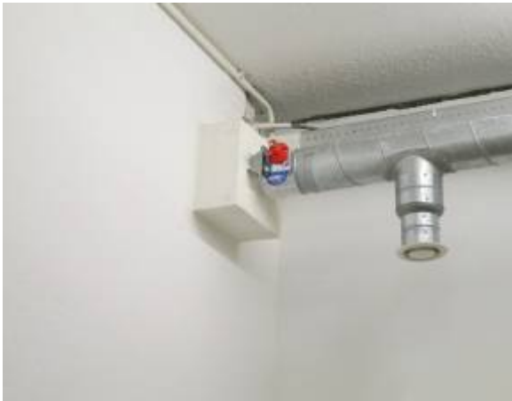
foto 7: Brandklep in afzuigstelsysteem.
