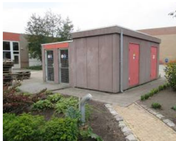
foto 6: Traforuimte met gasflessen opslag.
