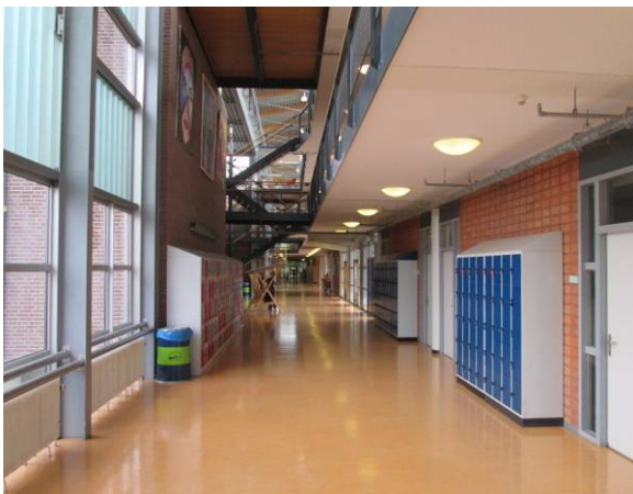
foto 5: Gang met sprinklerbeveiliging.
