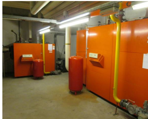
foto 16: Technische ruimte cv-verwarming.
