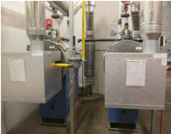
foto 13: Technische ruimte verwarming en klimaatbeheersing.
