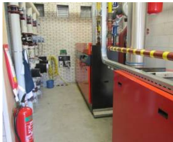
foto 8: Technische ruimte cv-techniek.
