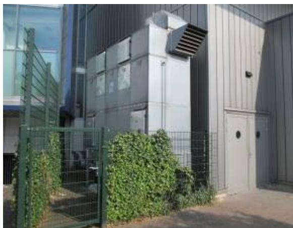
foto 5: Houtstof afzuiging buiten gebouw.
