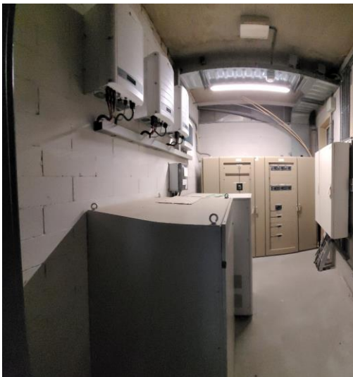
Figuur 6 LS-ruimte HV1 met omvormers
