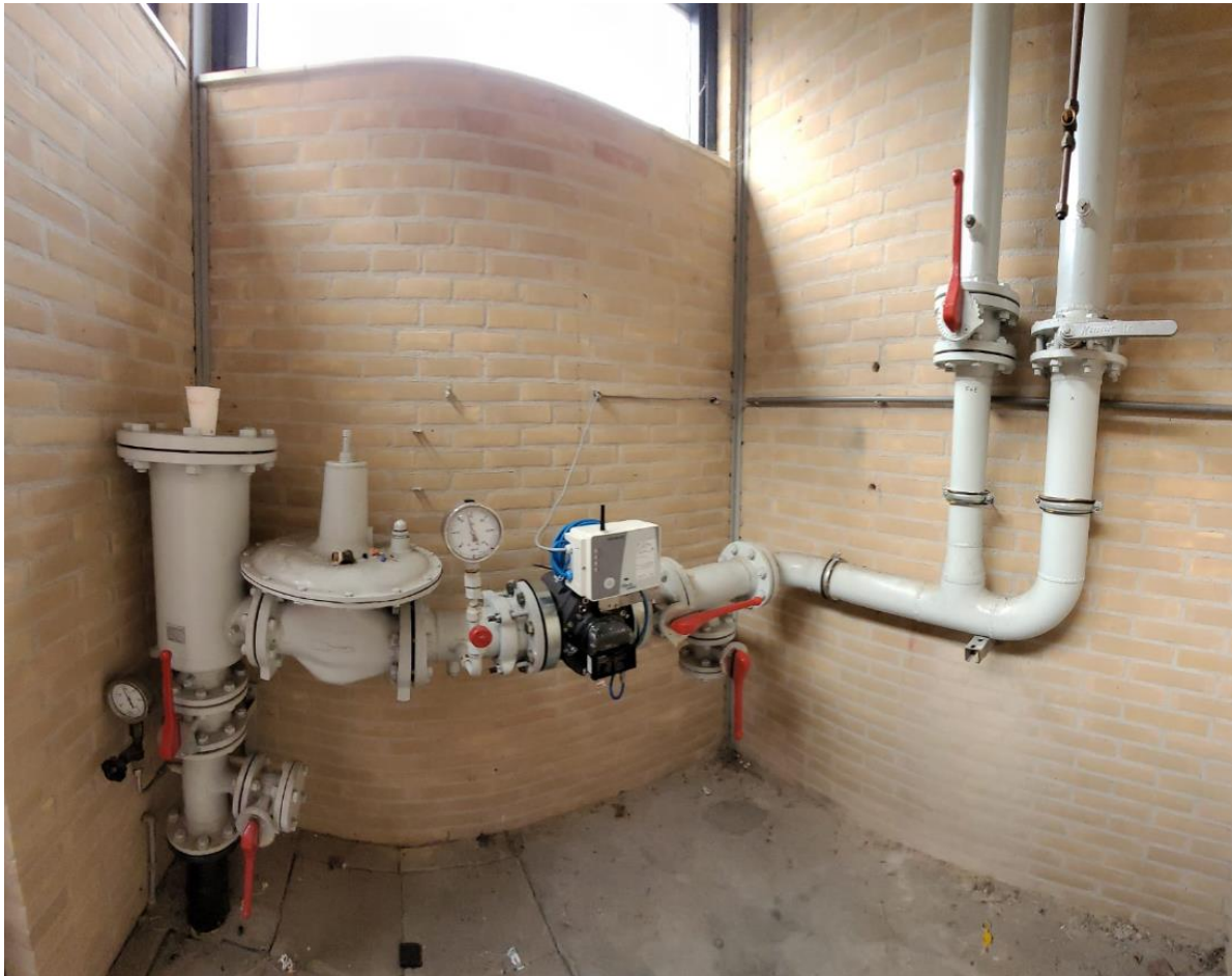
Figuur 2 bestaande gasmeter en groepsverdeling. Links bouwdeel E/F. Rechts (gesloten) voormalig aansluiting A.
