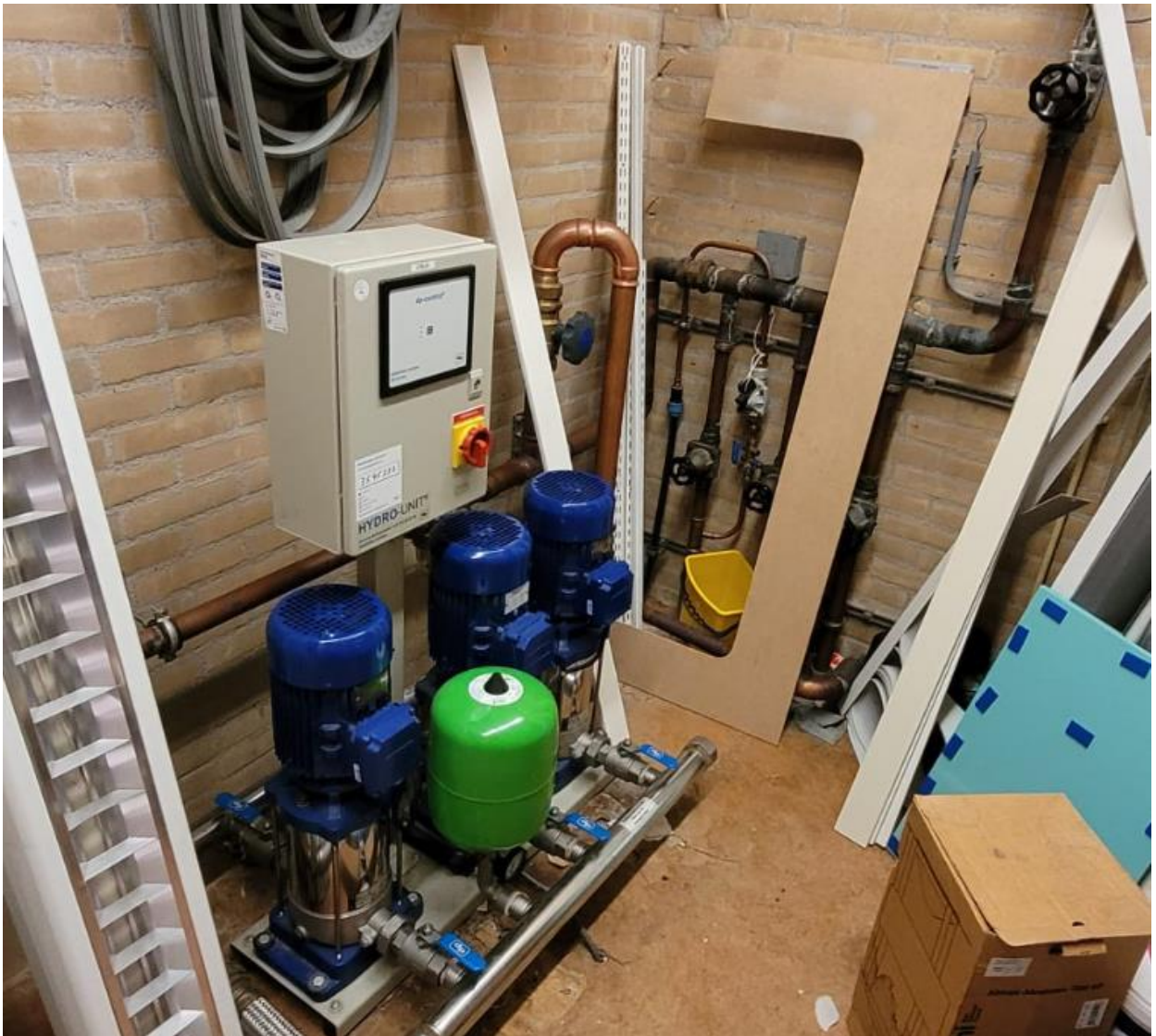
Figuur 1 Bestaande hydrofoor en waterverdeling.
