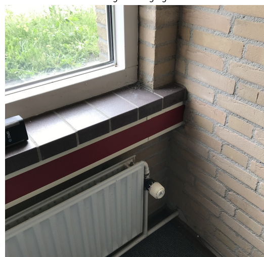
Foto 4: radiator en kabelgoot langs gevel
