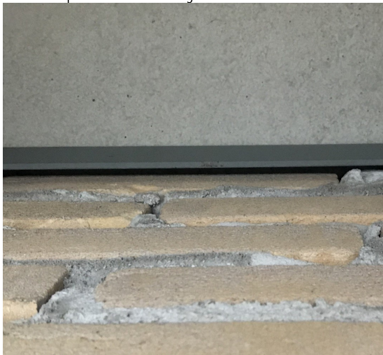
Foto 3: open naad aansluiting wand - vloer
