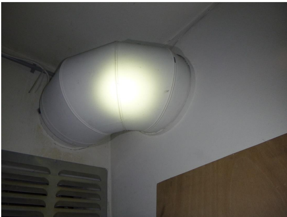
Foto 4: Zicht op de buizen ter plaatse van het rookgasafvoerkanaal achter de cv-ruimte (zie beperking in § 4.3).
