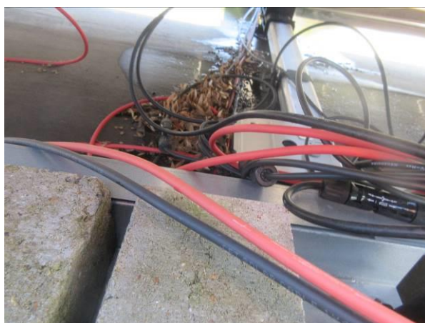
Connector en losse bedrading onder PV paneel
