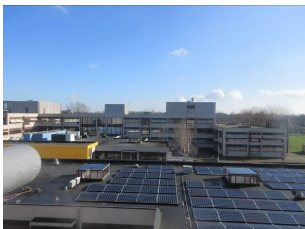
PV panelen op het dak van de tussenbouw
