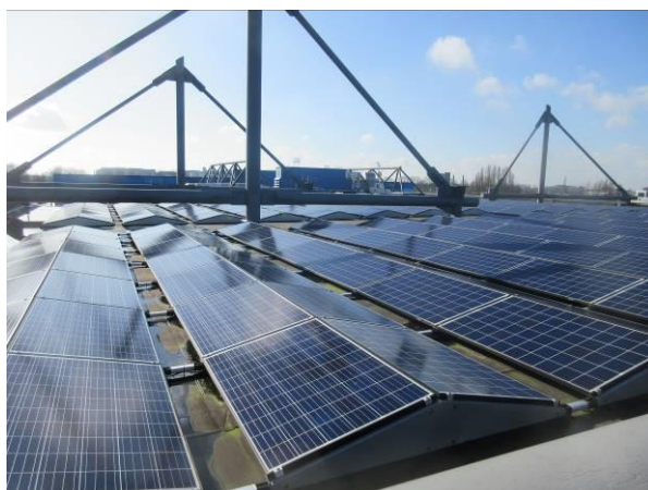
PV panelen op het dak van de sporthal
