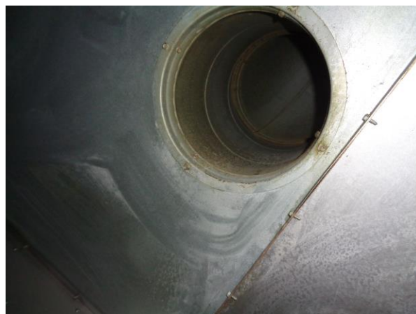
Inkijk afzuigkap en afzuigkanaal, minimale vetaanslag
