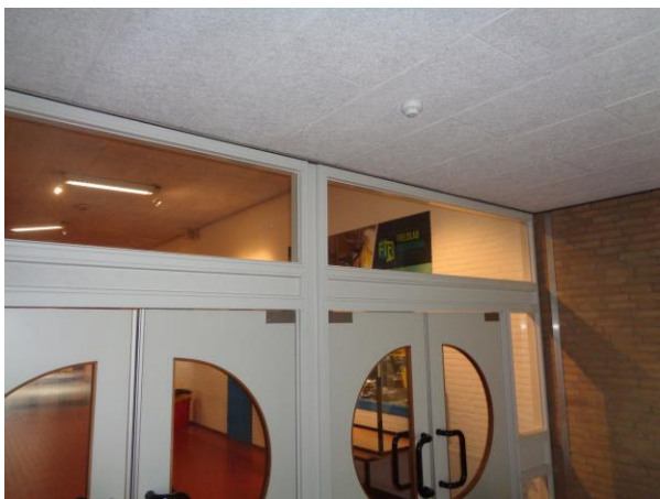
Lichte brandscheidingen met zelfsluitend branddeuren
