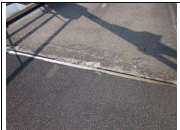
Voegovergang, staal niet waterdicht
