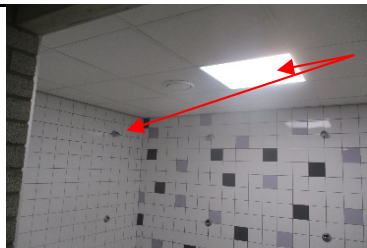
Foto 9. Alle stroomketens in ruimten met een bad of douche moeten zijn beschermd door een of meer toestellen voor aardlekbeveiliging met een toegekende aanspreekstroom van ten hoogste 30 mA.
