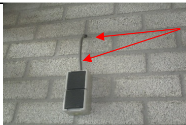
Foto 7. De kabel is niet deugdelijk bevestigd. De kabel is niet mechanisch beschermd.
