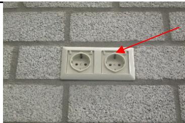
Foto 8. De klepjes van de wandcontactdozen zijn afgebroken.
