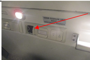
Foto 6. Het schakelmateriaal is beschadigd.
