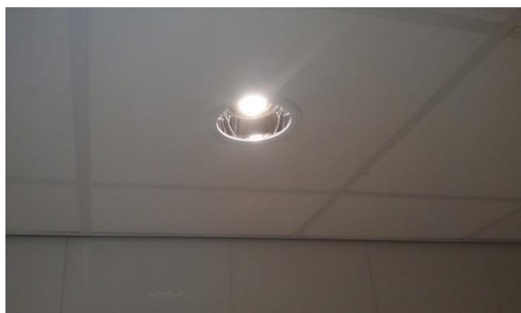
Figuur 4: LED verlichting toiletruimtes
