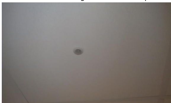
Figuur 5: Centrale bewegingssensor toiletruimtes
