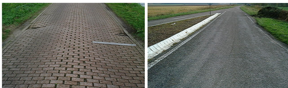
Figuur 2 Schades dwarsonvlakheid en rafeling
