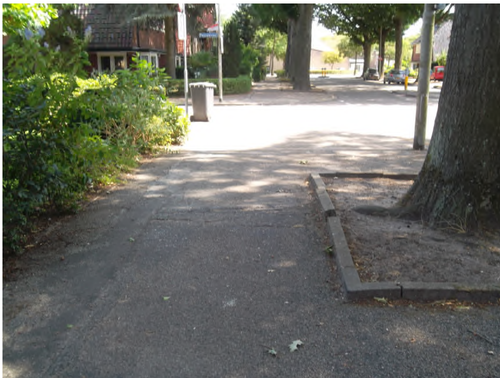
Foto 7. Pasteurstraat, met een voorbeeld van opdrukken verharding door wortels die naar de voortuinen groeien. Tevens is links in het asfalt de sleuf te zien die in het verleden gemaakt is tbv. kabels/leidingen, waarbij ongetwijfeld wortels zijn doorgezaagd.
