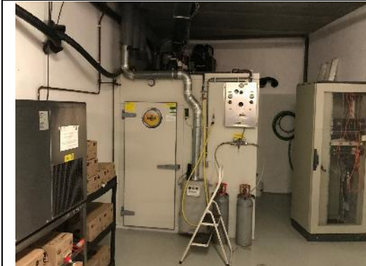
Tapinstallatie + CCVT installatie politie Terneuzen
