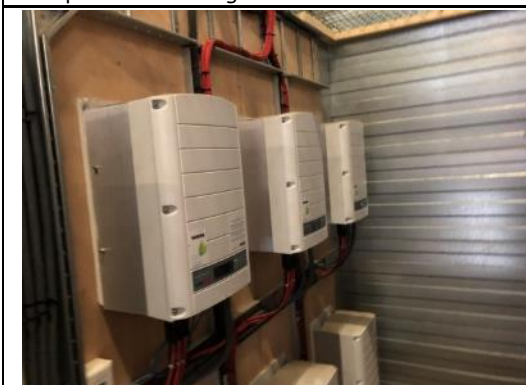
Omvormers PV installatie
