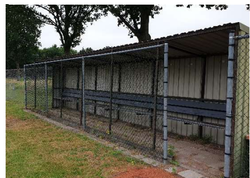
Figuur 11. Gevaarlijke opening in dug-out
