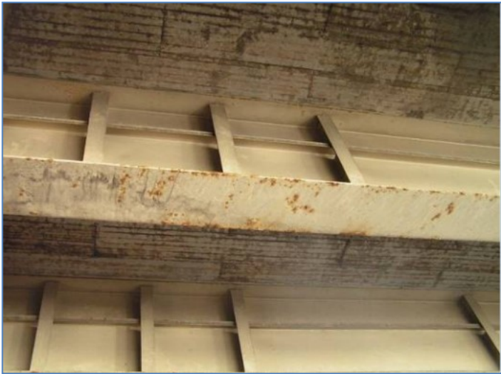
Figuur 4 (Links) Doorsnede hoofdligger en (rechts) aantasting van de onderflens door corrosie
