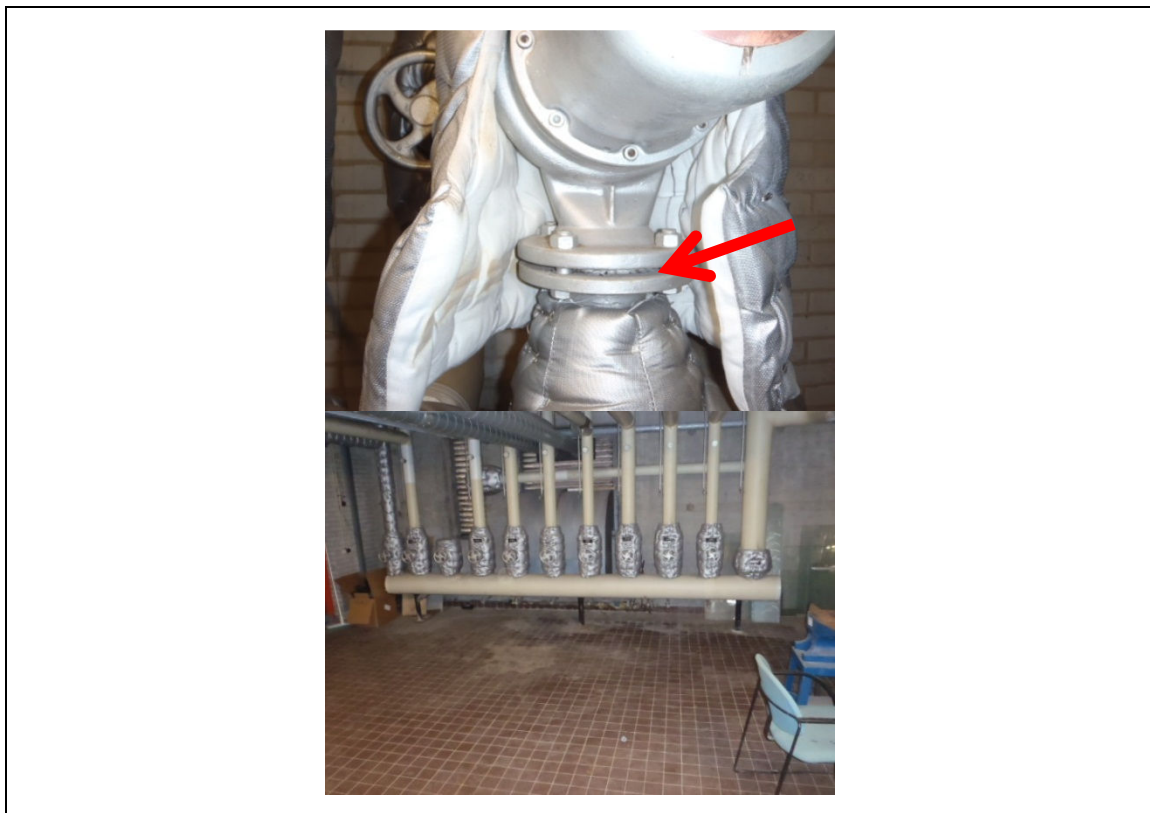
foto: 1a en 1b, afdichting cv-leidingwerk (pakking)
