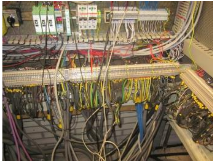
Fig. 10.1: Voorbeeld van overvolle kabelgoten en ontbreken trekontlasting.
