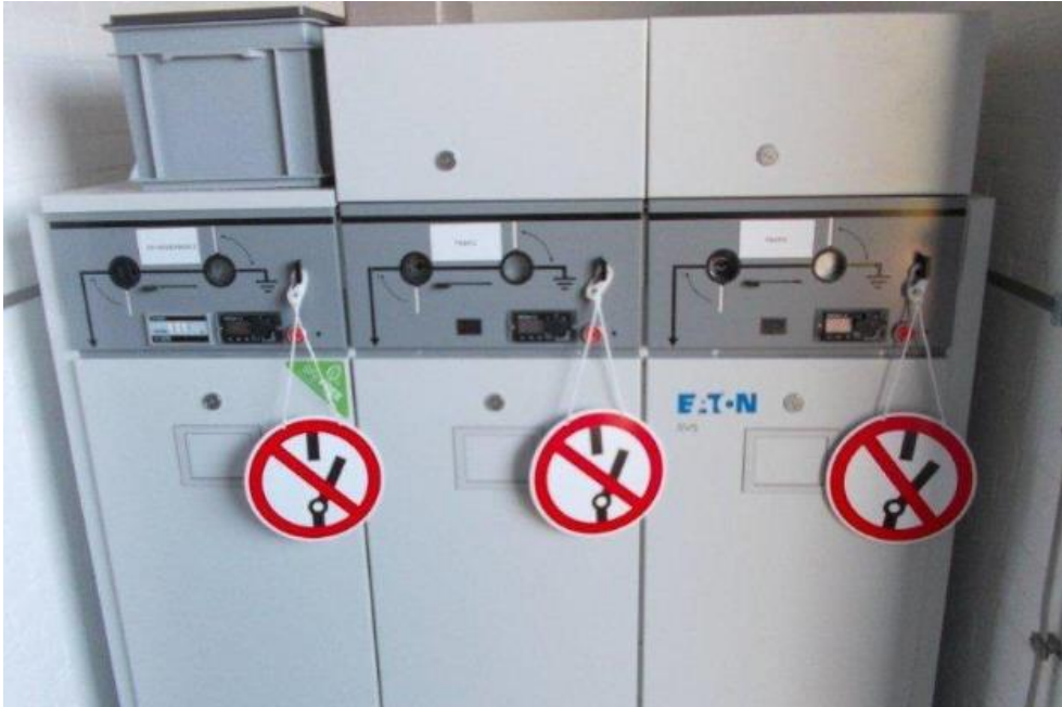
Fig. 8.1 Hoogspanning schakelinstallatie gemeaal Vier Noorder Koggen Holec SVS-6.
