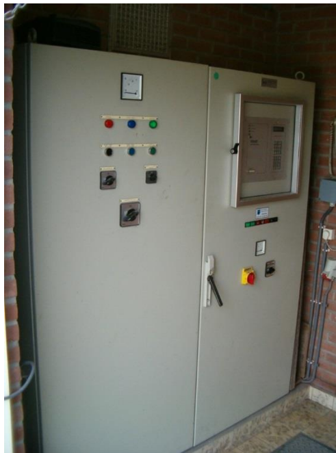
Fig. 3.1: Schakelkast van Watersystemen voor de bediening van een poldergemaal.
