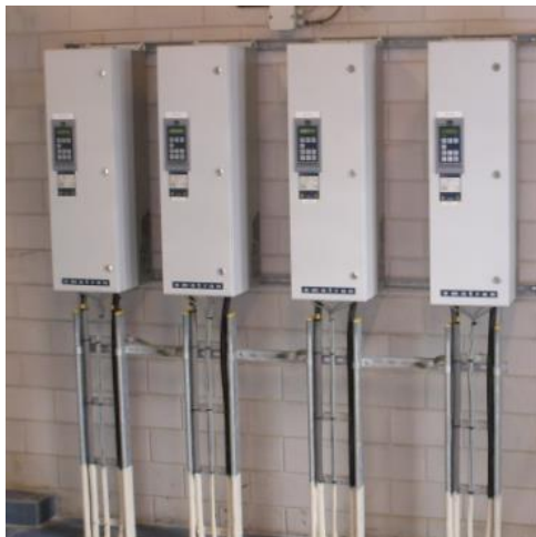
Fig. 19-5 : Frequentieomvormers in rioolgemaal Schagen (2011).
