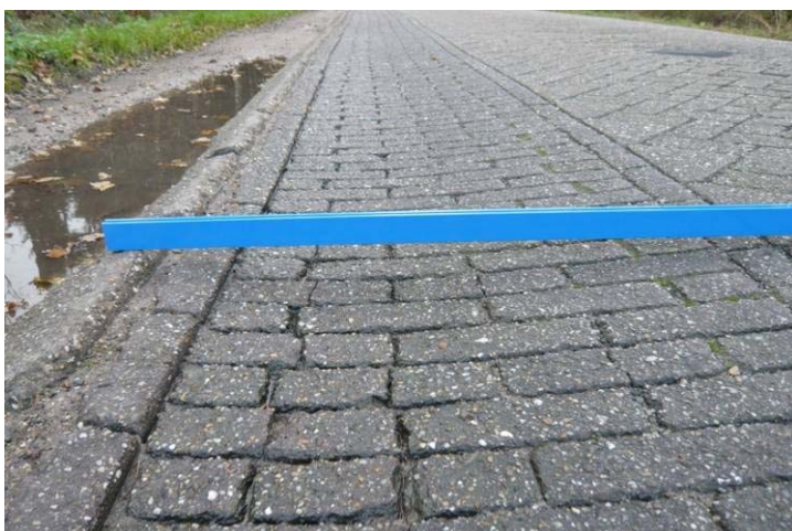
Figuur 5 Schadebeeld ernstige spoorvorming op elementenverharding
