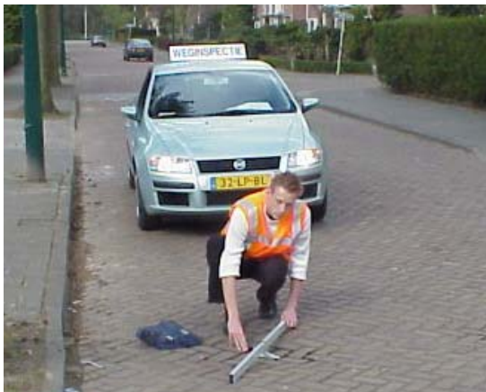
Figuur 4 Beoordelen schade tijdens globale visuele inspectie
