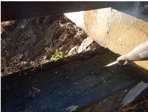
Figuur 4.1: De bovenzijde van beide langsliggers zijn aangetast door houtrot
