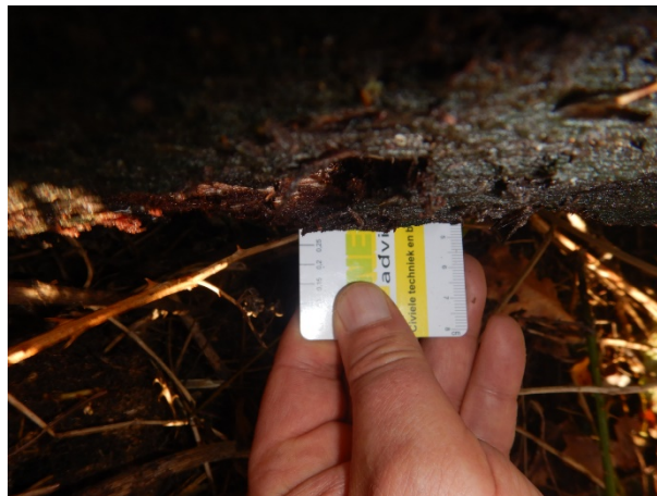
Figuur 4.4: Detail langsligger met aansluiting zuidwestelijk talud vertoont vergevorderde houtrot
