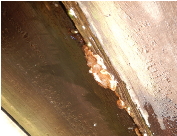
Figuur 4.7: Onderzijde rijdek vertoont lokaal schimmels en zwammen
