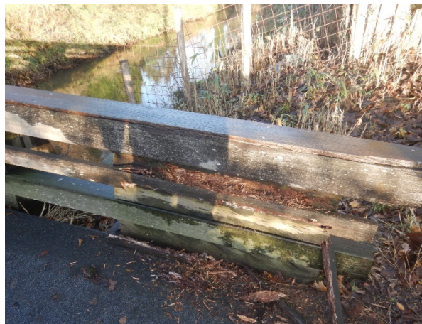
Figuur 4.9: De leuning vertoont aan de noord-oostzijde vergevorderde houtrot
