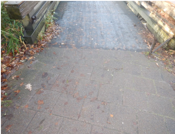
Figuur 4.14: De aansluitende elementenverharding vertoont aan de oostzijde geen gebreken
