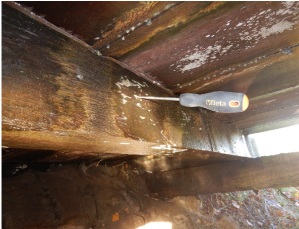
Figuur 4.5: De dwarsdragers onder het rijdek vertonen schimmel en houtrot
