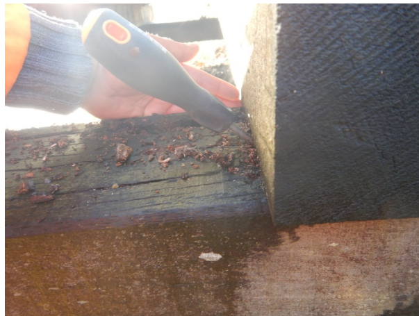
Figuur 4.2: Bovenzijde langsligger met aansluiting dwarsdrager vertoont houtrot
