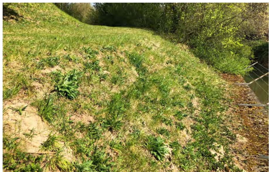
Figuur 47 Oostelijke deel van het talud boven de kademuur van Lunet I. De schaarsbegroeide plekken zijn duidelijk zichtbaar.
