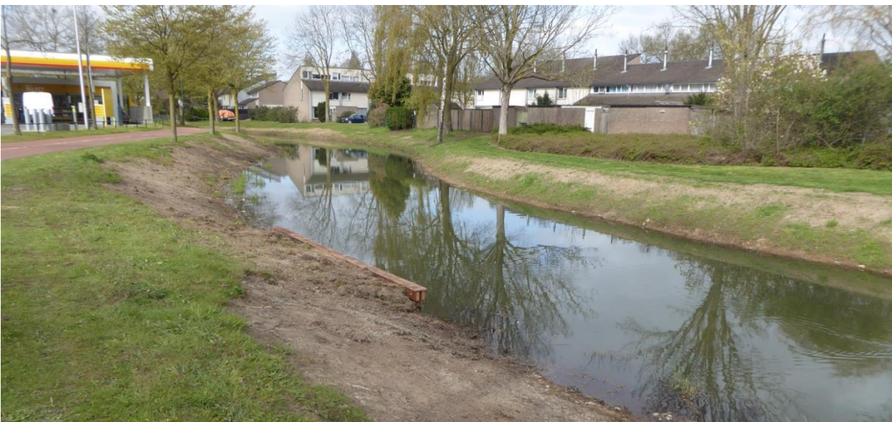
Figuur 4. Bij het aanleggen van natuurvriendelijke oevers wordt de beschoeiing verwijderd en wordt van een deel van het talud verwijderd. De foto is elders in 's-Hertogenbosch, buiten het plangebied, gemaakt.
