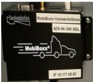
Figuur 46: Mobiboxx unit Technische ruimte
