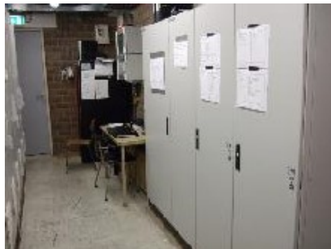
Figuur 62: Technische ruimte (rechterzijde) met deur naar NSA ruimte
