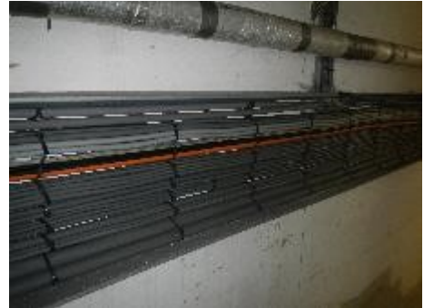
Figuur 77: Ladderbaan in kelder
