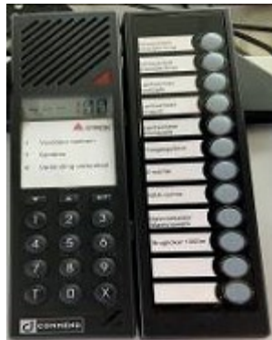
Figuur 42: Omroep + Intercom unit Bedienplek
