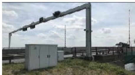
Figuur 54: bruglichtportaal hoofdrijbaan
