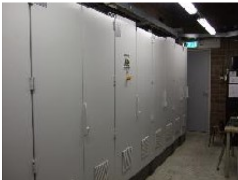
Figuur 61: Technische ruimte (linkerzijde) met deur naar NSA ruimte
