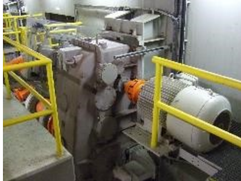
Figuur 28: Brugzijde west: Hoofdmotor en tandwielkast
