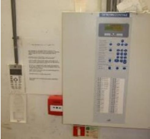
Figuur 72: Brandmeldcentrale en bedienpaneel toegangscontrole in toegangsruimte
