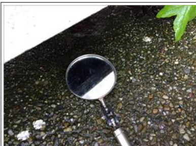
Omkanten onvoldoende behandeld
